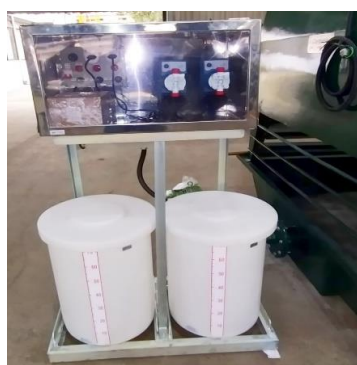
Tanques químicos e bombas dosadoras
