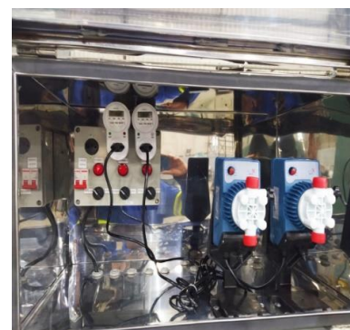
Painel de comando
