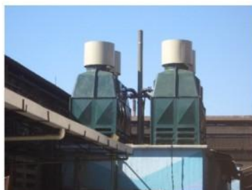
Torre de Resfriamento
